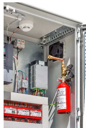
Rys. 12. SUG wewnątrz centrali.
